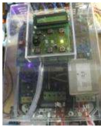
Gambar 4. VSD kondisi siap
