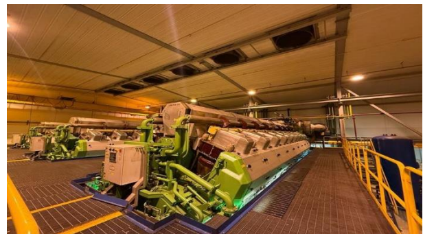
Gambar 1 Mesin PLTDG Unit 10,11 & 12 (Sumber: PT. PLN Indonesia power UBP Bali, 2025)
