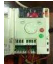
Gambar 3. Settingan Altivar Kondisi Ready
