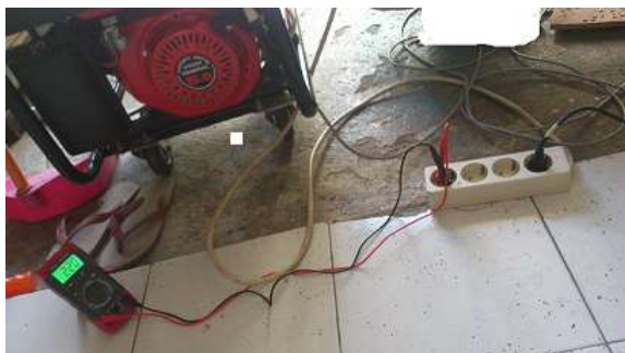
Gambar 22. Pengujian waktu Pada tegangan 220 Vac
