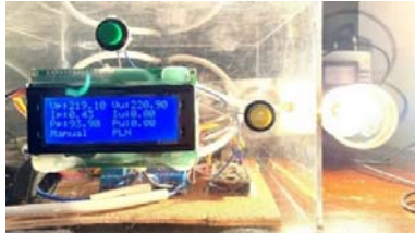
Gambar 14. Kondisi ATS mode manual PLN saat PLN normal (beban disuplai PLN)
