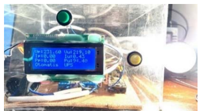
Gambar 9. Kondisi ATS mode otomatis saat PLN undervoltage (suplai UPS)
