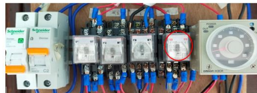
Gambar 11. Indikator LED pada relay ATS di sumber PLN menyala
