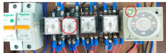
Gambar 12. Indikator LED pada relay ATS di sumber inverter mati
