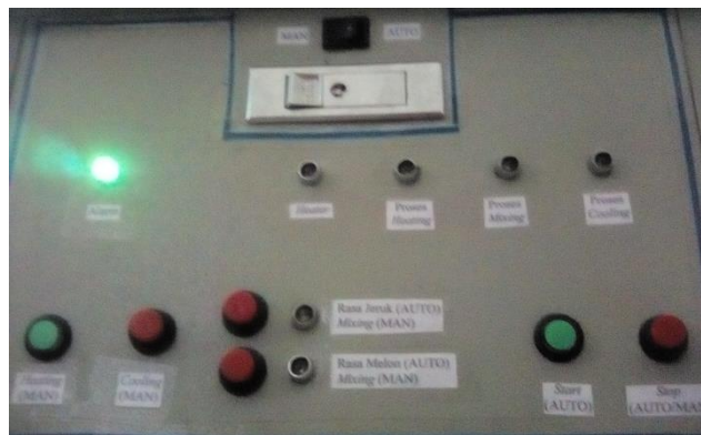
Gambar 9. Kondisi Panel Box Sistem Alarm Aktif
