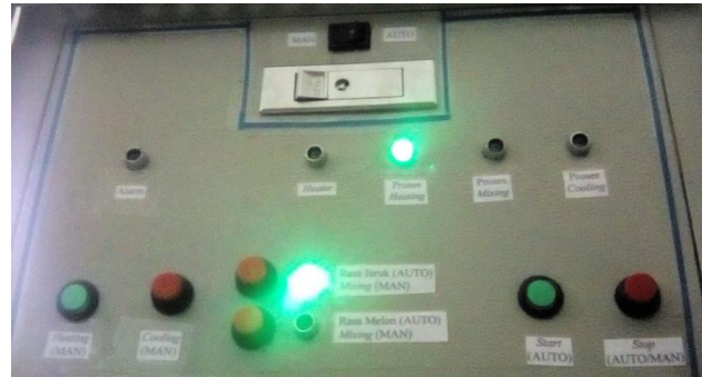
Gambar 8. Kondisi Panel Box Saat Proses Heating
