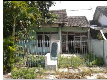
Sumber : Hasil Observasi Lapangan, 2014 Gambar 3 Kerusakan Akibat Longsor Tingkat Major Di Perumahan Bukit Manyaran Permai
