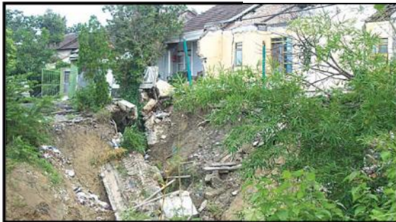
Sumber : esdm.go.id dan Hasil Observasi Lapangan, 2014 Gambar 2 Longsor Rotasi/Setengah Rotasi Di Perumahan Bukit Manyaran Permai
