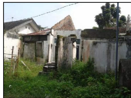
Sumber : Hasil Observasi Lapangan, 2014 Gambar 4 Kerusakan Akibat Longsor Tingkat Catastrophic Di Perumahan Bukit Manyaran Permai
