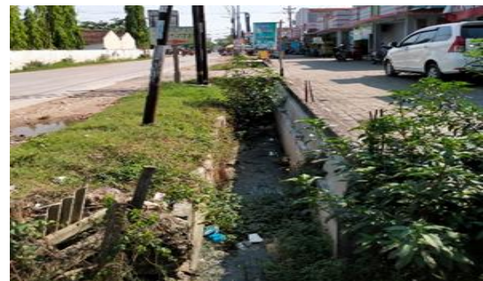
Gambar 6. Drainase Tersumbat Rumput dan Sampah (Analisis, 2022)
