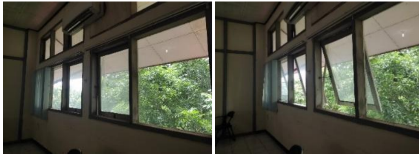
Gambar 5. Kondisi jendela pada saat pengambilan data (a) Kondisi saat jendela tertutup semua (b) Kondisi saat sebagian jendela terbuka
