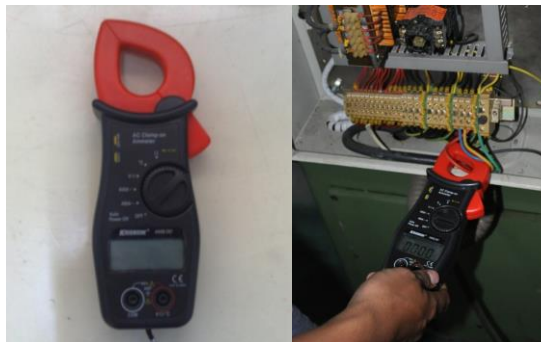
Gambar 5. AC Clamp-on Ammeter dan Letak pemasangan AC Clamp-on Ammeter
