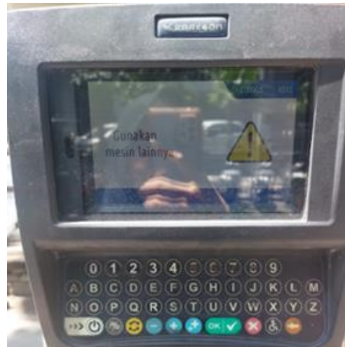
Gambar 5. Trouble pada mesin parkir meter
