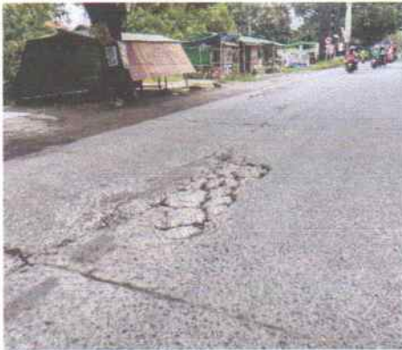
Gambar 1.2 Akses Jalan yang rusak
