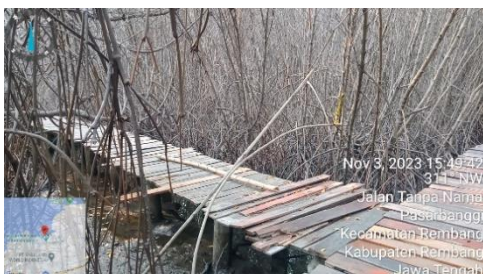
Gambar 5. Area Jembatan Ditutup karena Kayunya Rapuh
