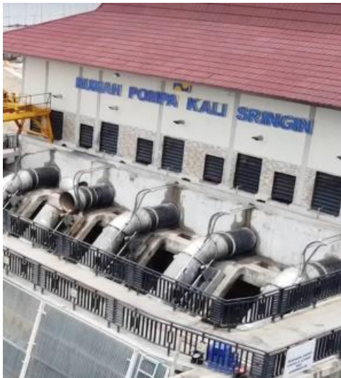
Gambar 3.4 Infrastruktur Rumah Pompa Sringin di Kota Semarang Sumber: Dokumentasi Instagram @pupr_sda_pamalijuana (2023)
