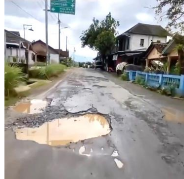
Gambar 1.1 Kerusakan Akses Jalan Wisata Goa Pindul
