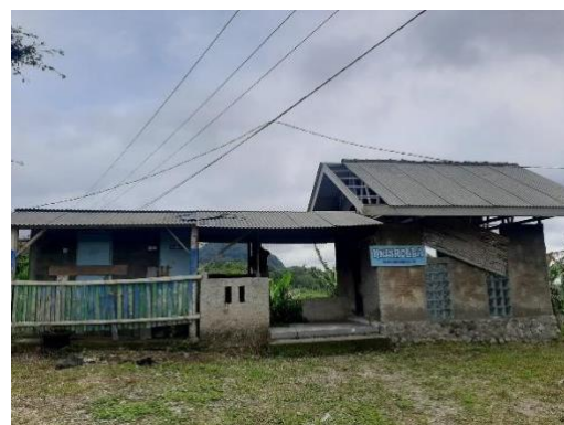
Gambar 1. 1 Toilet dan mushola yang rusak dan terbengkalai
