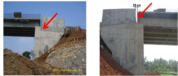
Gambar Abutmen Miring Dan Terdapat Celah Rongga 20 cm
