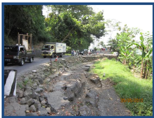
Gambar Situasi Kelongsoran Jalan
