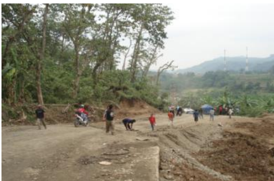
Gambar Situasi Kelongsoran Jalan
