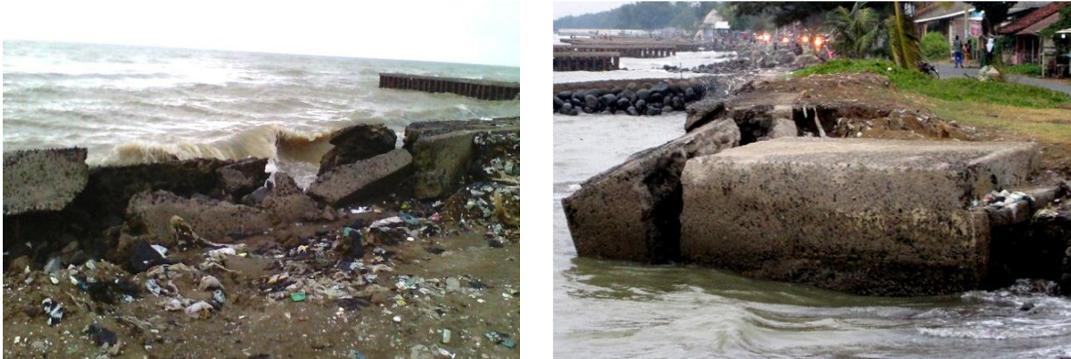
Gambar 1. Rusaknya pengaman pantai eksisting ( seawall ) akibat gelombang
