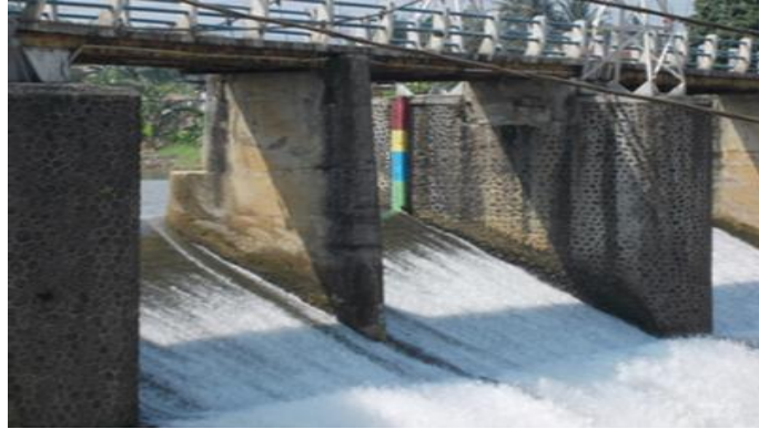
Gambar 4. Pemantau Tinggi Muka Air.
