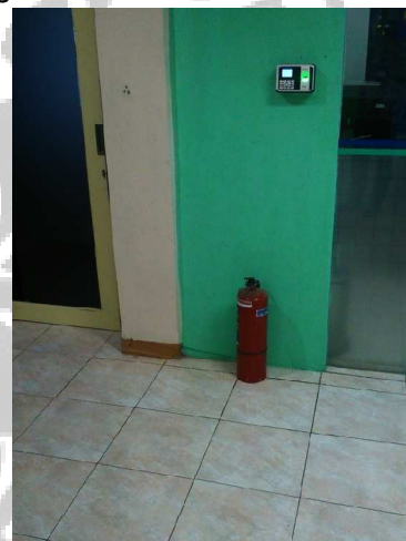
Gambar 1. Contoh Pemasangan APAR yang tidak Sesuai dengan Permenaker No.04/MEN/1980
