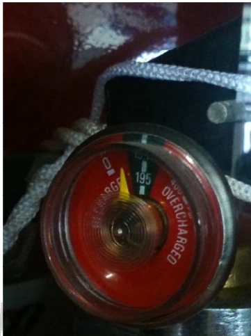
Gambar 2. Kondisi APAR yang terindikasi kerusakan
