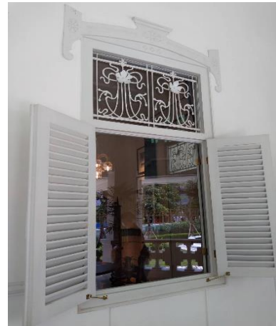
Gambar 8 : Kondisi Terkini Pada Elemen Fasad Omah Lowo Surakarta Sumber : Dokumentasi Pribadi
