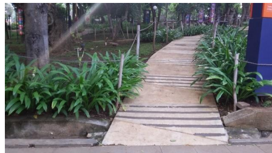
Gambar 6 : Kondisi Jalur Pedestrian 2
