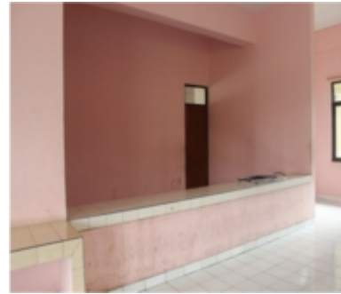
Gambar 3. salah satu fasilitas Asrama Haji yang tidak terawat
