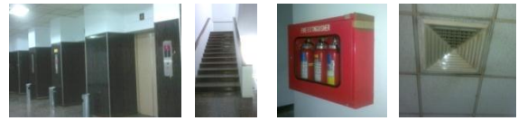
Gambar 10. Sistem mekanikal elektrikal pada kantor gubernur Jawa Tengah Sumber : Dokumentasi Penyusun
