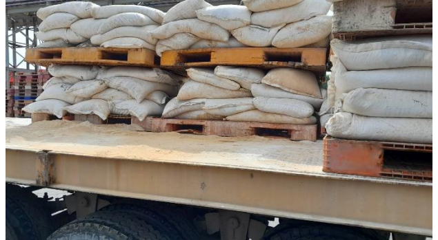
Gambar 4 Material Tumpah Tidak Dibersihkan
