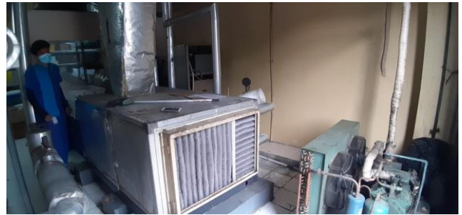
Gambar 13 Kondisi Lingkungan Kerja Ruang AHU
