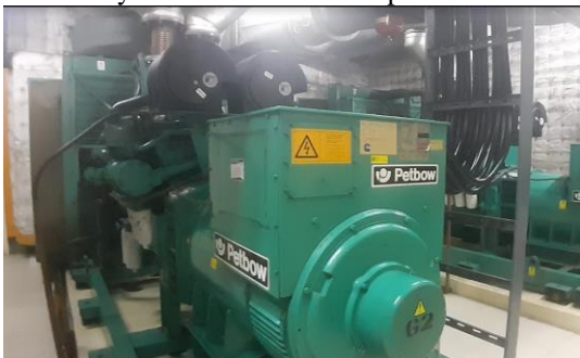
Gambar 9 Generator milik RS Premier Bintaro untuk Backup Listrik
