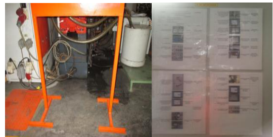
(a) (b) Gambar 5. Mesin yang belum dipasang safety procedure (a) dan gambar safety procedure (b)
