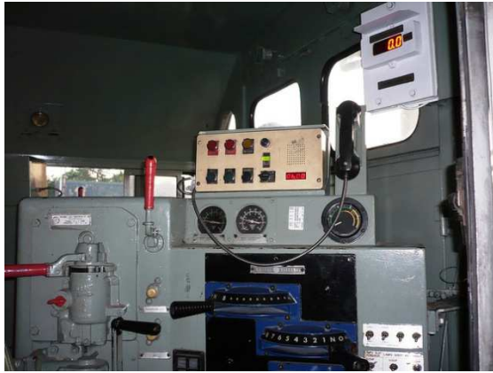
Gambar 11. Panel Kontrol dan Display Lokomotif CC203
