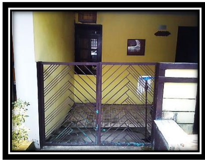
Gambar 5 Rumah/Bangunan Kondisi Rusak Ringan
