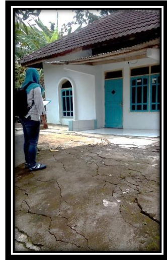
Gambar 4 Rumah/Bangunan Kondisi Rusak Sedang
