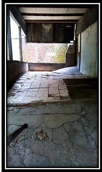
Gambar 3 Rumah/Bangunan Kondisi Rusak Berat
