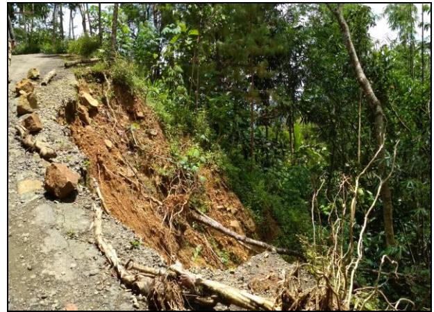
Gambar 12. Kejadian Gerakan Tanah di Kecamatan Selogiri
