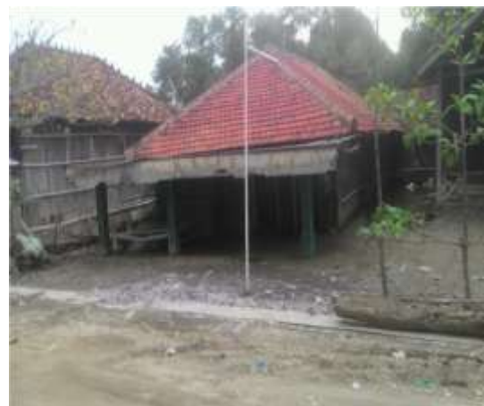
Gambar 9. Kondisi Rumah warga yang sudah tidak layak huni
