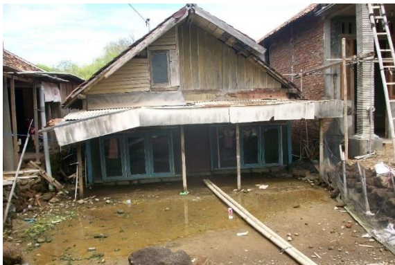
Gambar IV.10. Tempat Tinggal yang Tidak Layak
